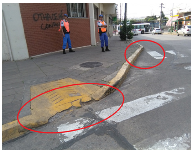
Fig. 3 Rampa sobre una sola senda peatonal, además, con roturas
