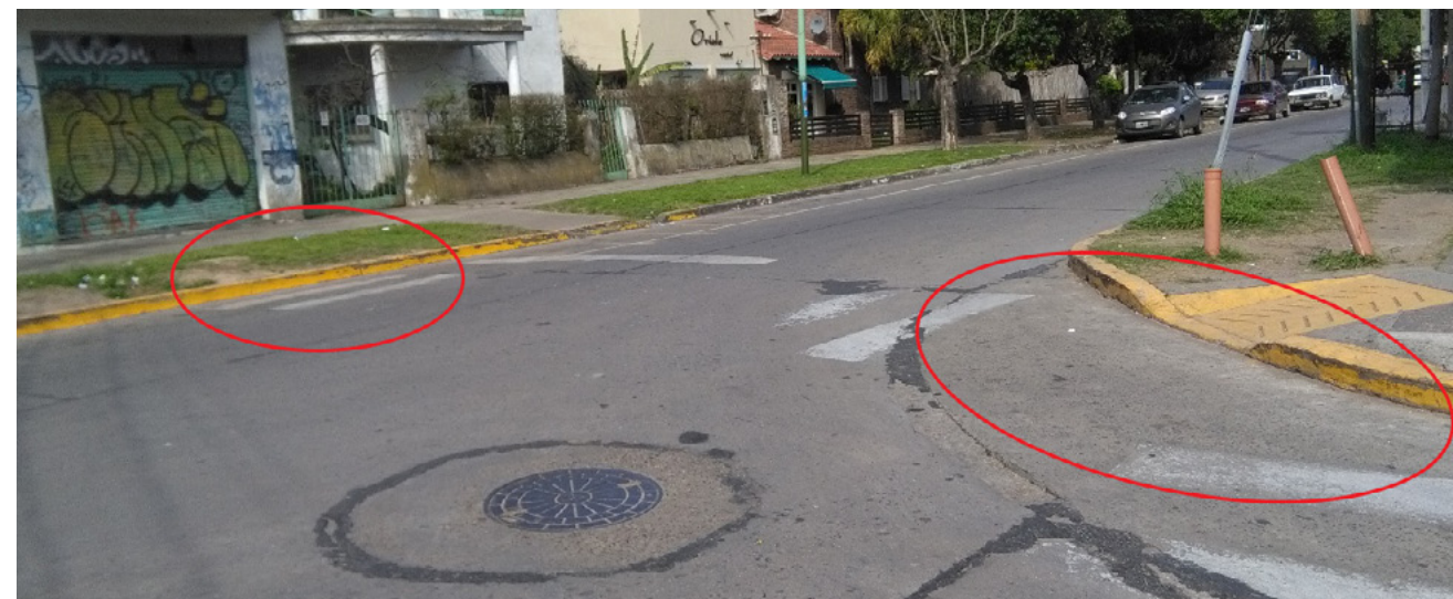
Fig. 4 - Rampa en la diagonal y faltante de rampa en el otro extremo de la senda peatonal
