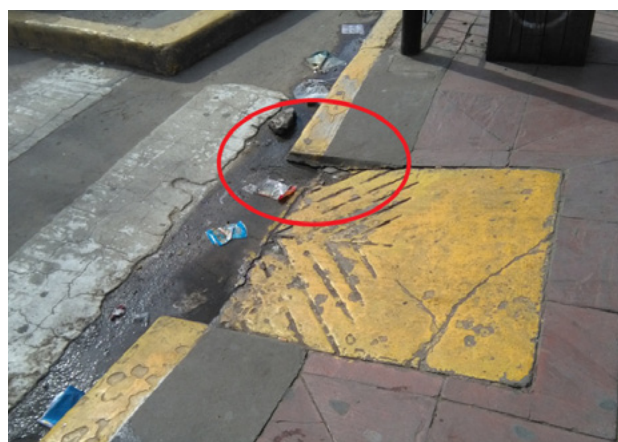
Fig. 2 Rampa de ejecución incorrecta
